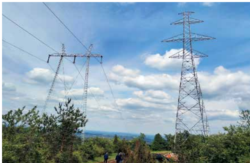
Стуб бр. 95 ДВ 213-1 и стуб бр. 102 будућег ДВ 2x400kV ТС Бајина Башта - ТС Обреновац
