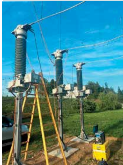
Оптички струјни трансформатори у пољу Е09 током испитивања
