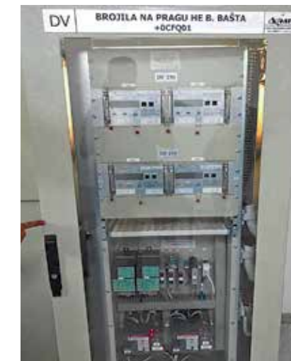
Слика 2: Мерила квалитета електричне енергије након монтаже и комуникационог повезивања у ХЕ Бајина Башта
