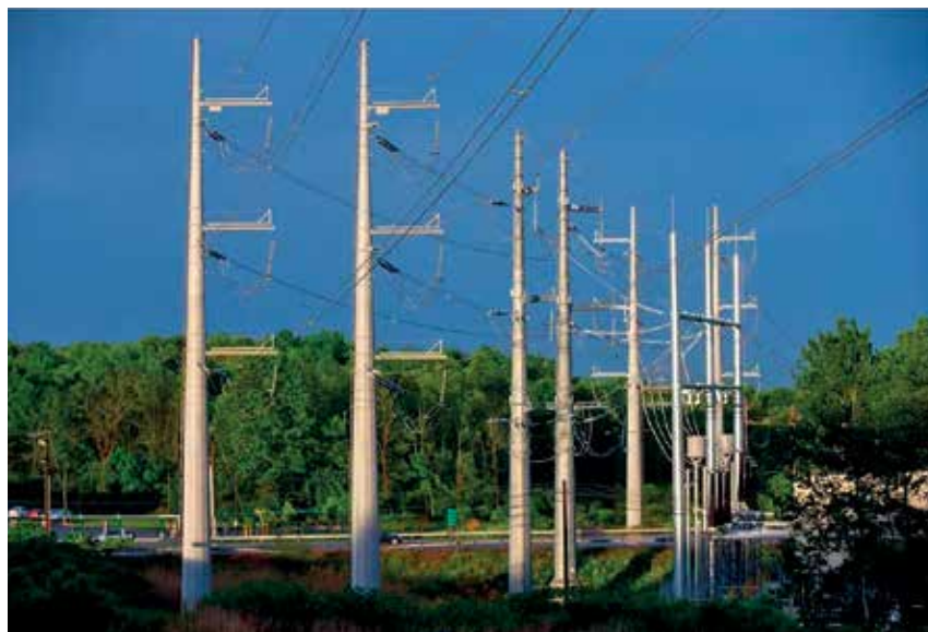
Објекти предузећа NYPA: преносни надземни водови и трафостаница који су део 345 kV преносног система, код Авеније Долсон
