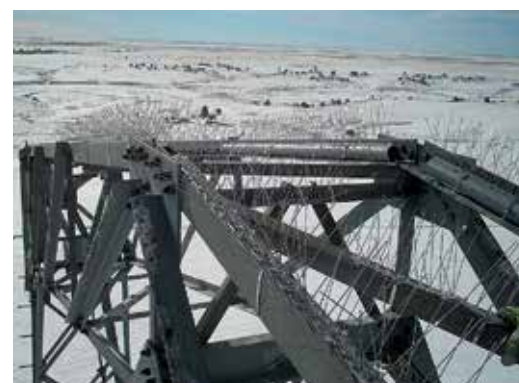
Конструкција за одвраћање птица постављена на 500 kV стуб
