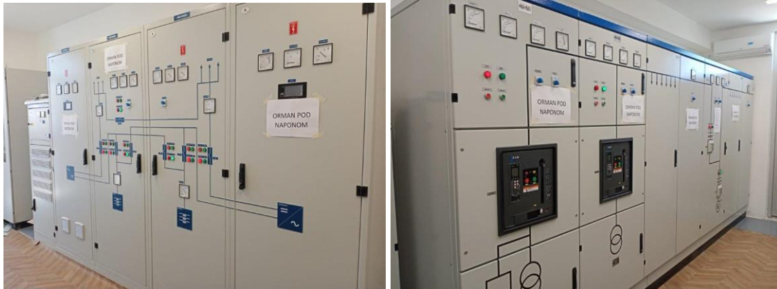
Ормани главног наизменичног и једносмерног развода сопствене потрошње у ТС 400/220/110 kV Краљево 3
