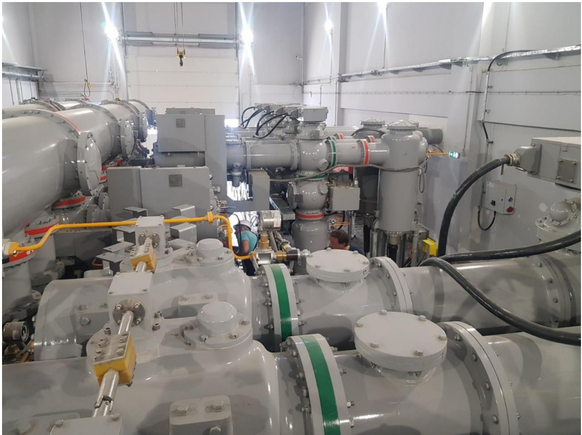
Гасом изоловано постројење – ПРП 220 kV Панчево
