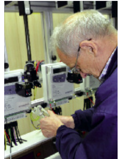
Водећи контролор Слободан Миленковић жигоше Трансформаторско бројило
