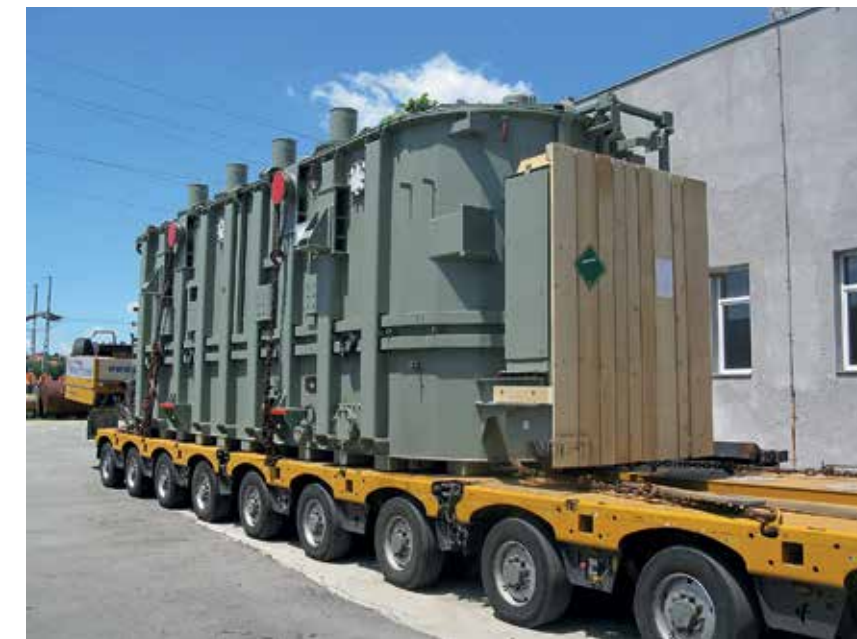
Трансформатор 250MVA, преносног односа 220/115/10.5 kV на локацији Централног магацина
