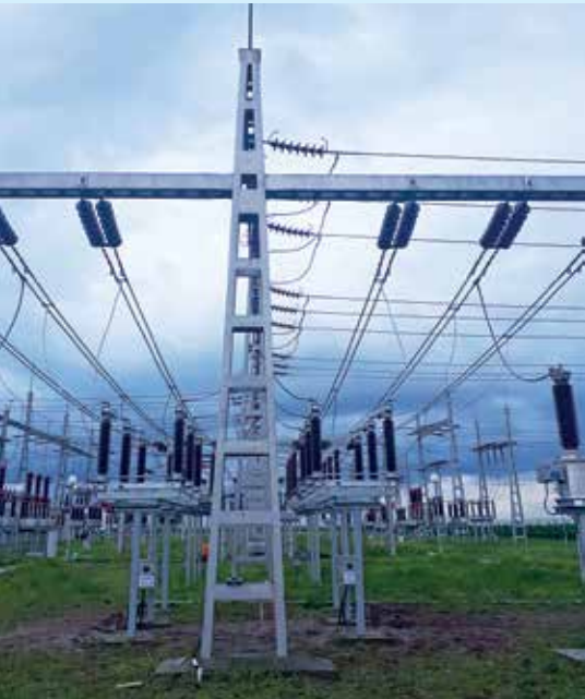
Растављачи за даљинско управљање на ТС Зрењанин 2
