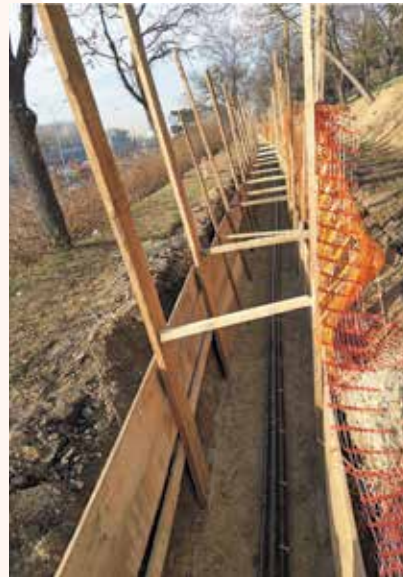
Положен кабловски вод на деоници бр. 3, КБ 110 kV ТС Београд 23 – ТС Београд 45
