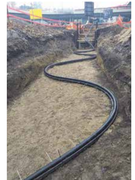
Извођење резерве испод спојнице на деоници бр. 6, КБ 110 kV ТС Београд 23 – ТС Београд 45
