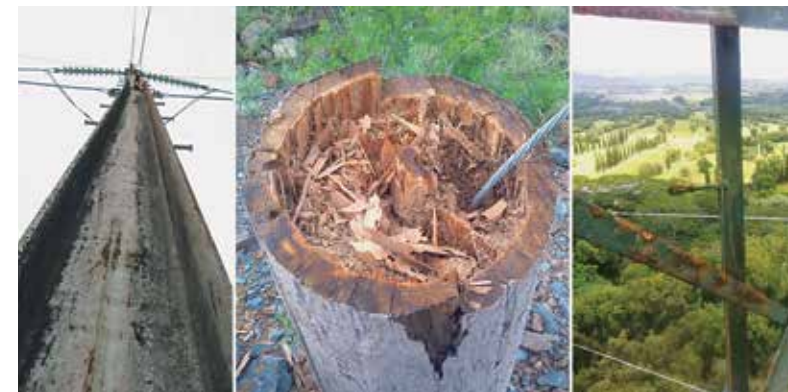
Примери инфраструктуре преносног система на острву Оаху која је предмет пажње: деформације на стубној конструкцији, оштећења од термита и корозија металних делова
