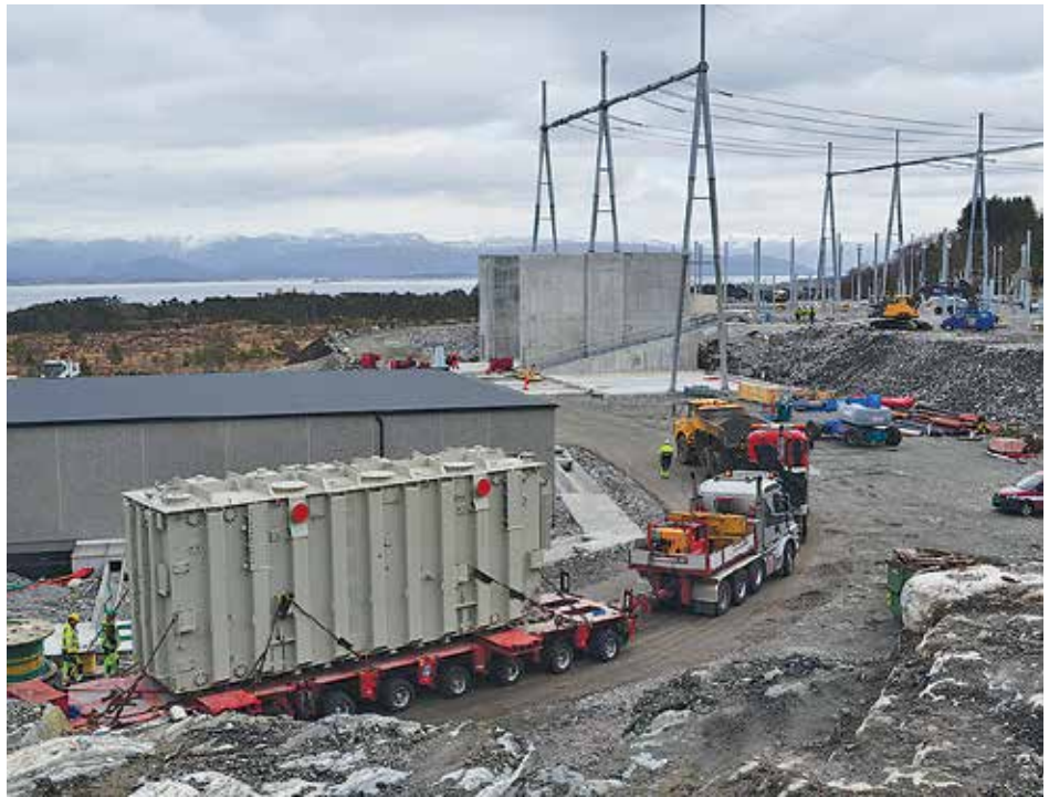
300 MVA, 420/300/132 kV трансформатор је транспортован из Хрватске до западне обале Норвешке
