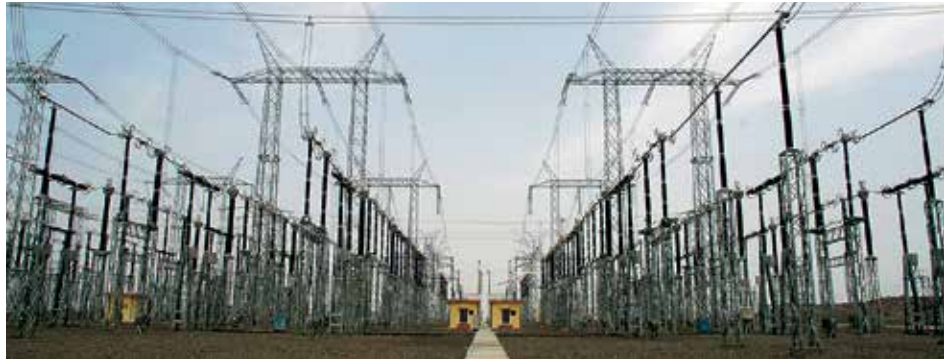
765-kV трафостаница Дуле је пројектована да прихвати седам 500MVA, 765/400-kV трансформатора и једанаест 80MVAR, 765kV пригушница.
