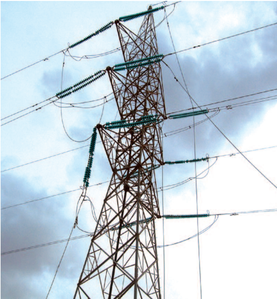
Пример оштећења на 220 kV преносном воду
