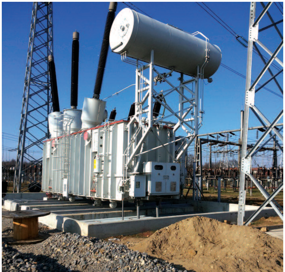
ТС Смедерево 3 - нови енергетски трансформатор 400/110 kV, 300 MVA
