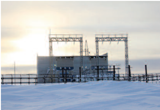
Трафостанице 110 kV напонског нивоа попут ове изграђене на северу територије снабдевају углавном индустријске потрошаче чија се потрошња не мења знатно током уобичајеног дана
