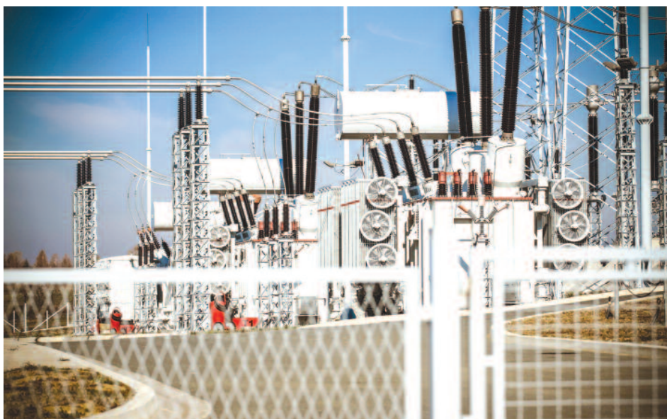
Само у 2015. години у ЕМС-овим трафостаницама уграђено пет нових трансформатора укупне снаге 1.600 MVA
