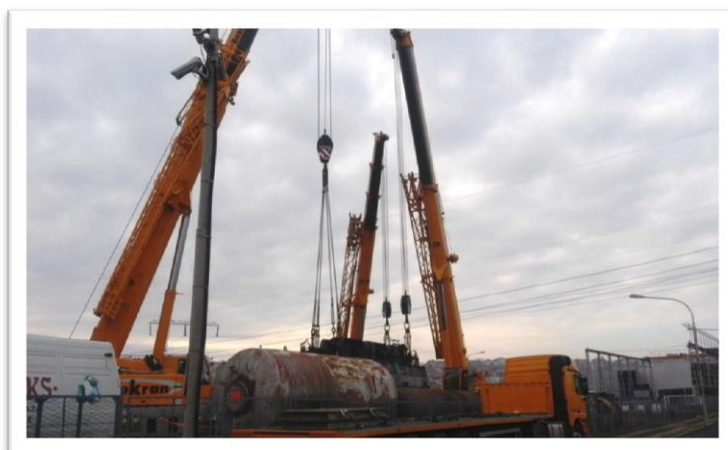
Предаја отпадног трансформатора оператерима - Погон Београд
