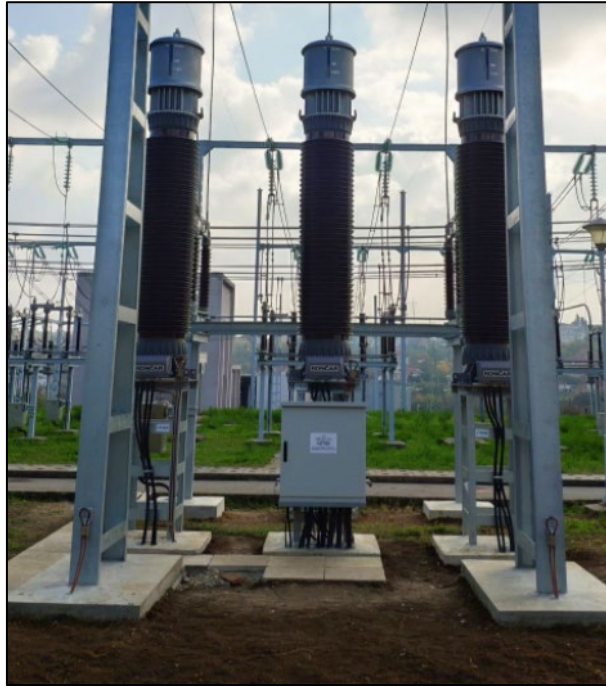
Напонски трансформатор велике снаге 3x100kVA
