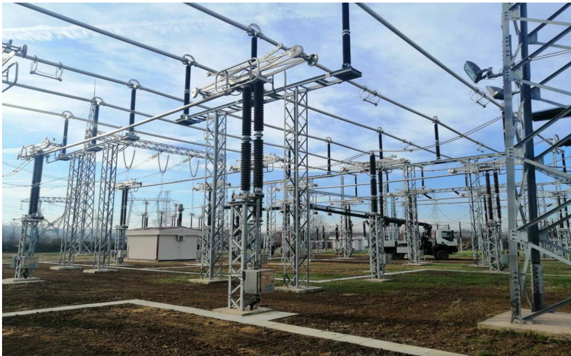
ТС Смедерево 3 – разводно постројење 400kV
