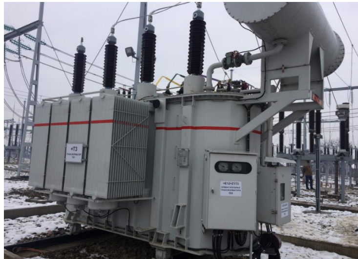
Нови трансформатор у ТС Крушевац 1
