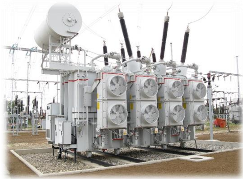
Нови трансформатор у ТС Крушевац 1
