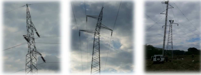
Хаварија на ДВ 110 kV бр. 128/4 ТС Нересница – ТС Петровац
